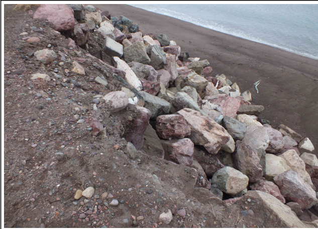
Tassement enrochements extrémité parking
