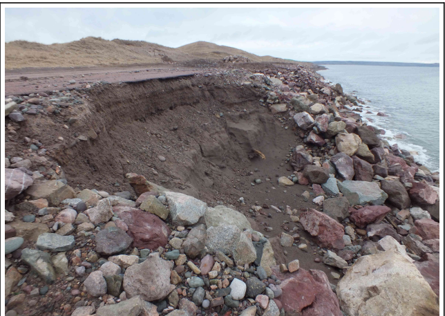
Effondrement devant l'effondrement de la plateforme centrale (PK16)
